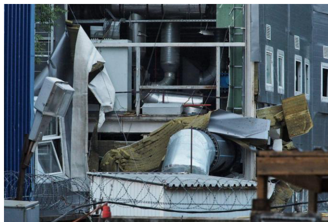
Рис. 4. Разрушения цеха воздухоочистки в результате аварии 2020 года
